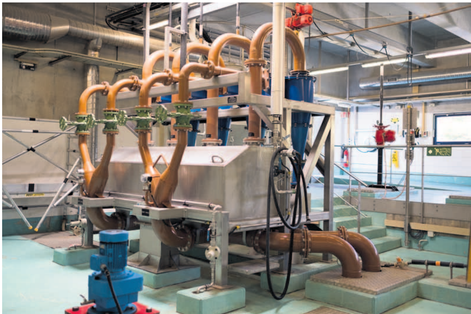
Équipements de récupération des boues.
