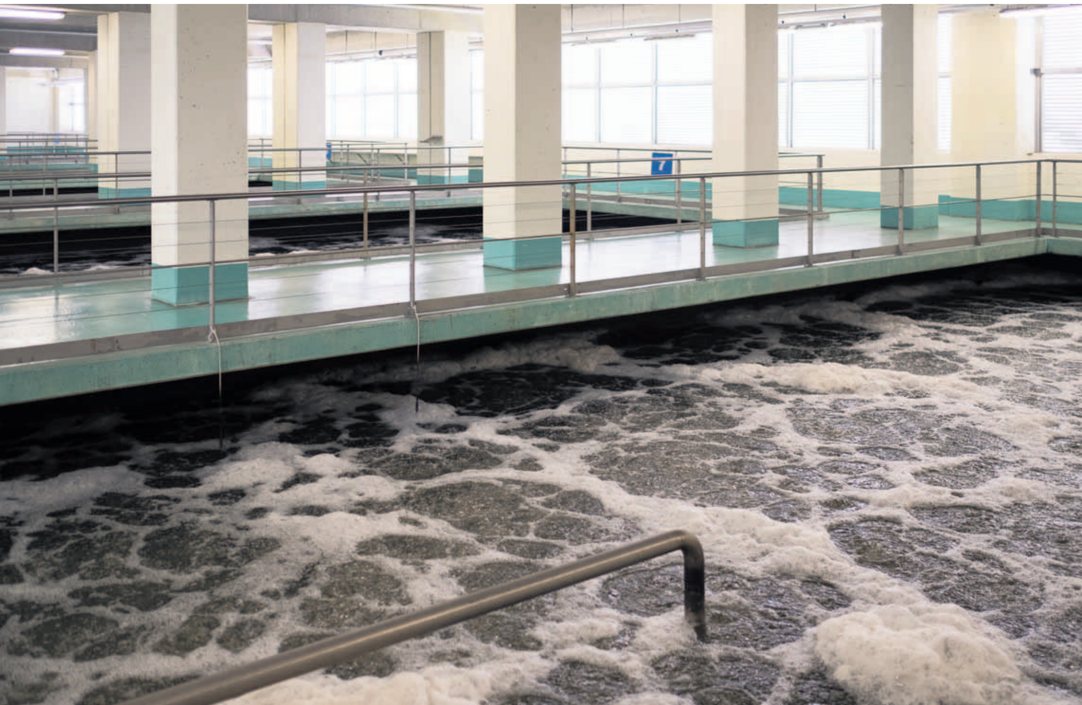
Bassin de traitement biologique.
